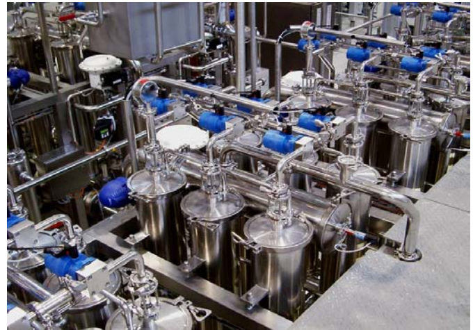
Sistema MMS de concentración pre-evaporación
